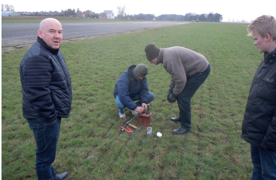
Herstelling van de lierkabel. 2 man werken, 2 man kijken of het goed gebeurt...
